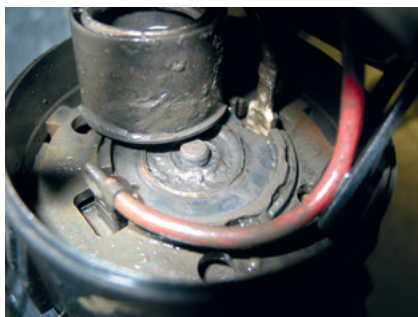
Aggressives Abgaskondensat im Antriebsmotor einer Sekundärluftpumpe
